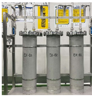
医薬品用樹脂塔
