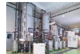
イオン交換樹脂再生設備
