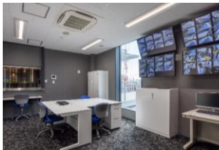
■ 防災センター
