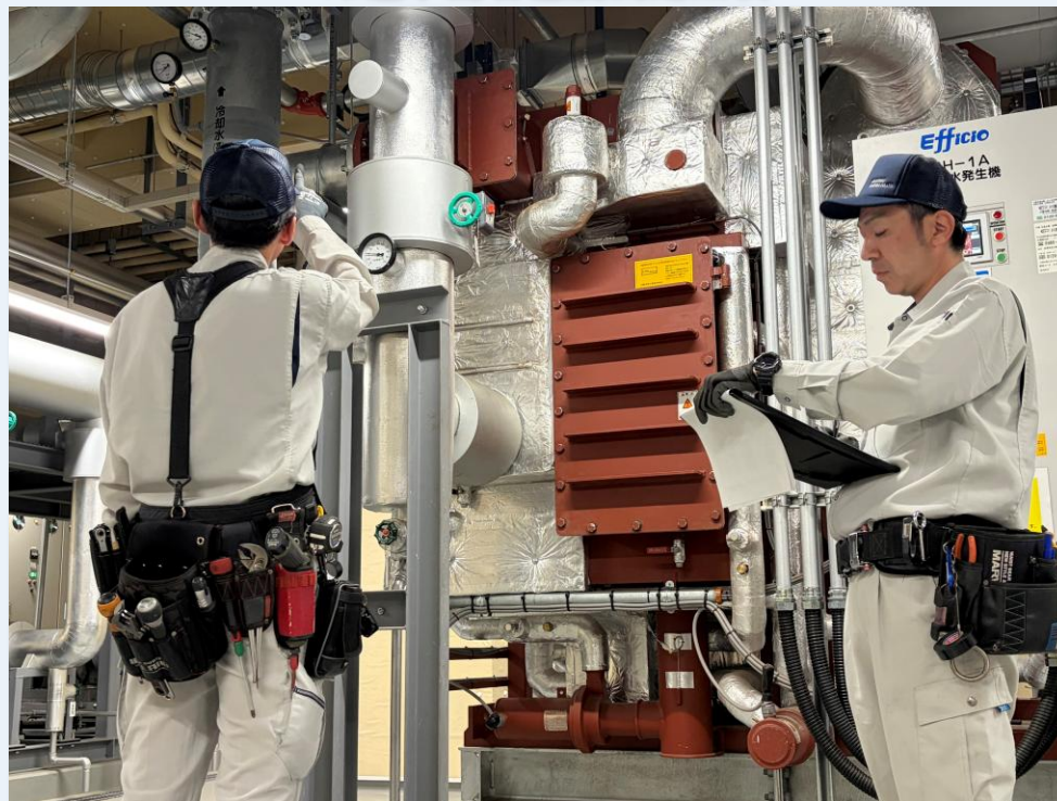
熱源機械室 冷温水配管温度測定点検
