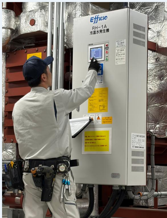
熱源機械室 冷温水発生機データ測定点検
