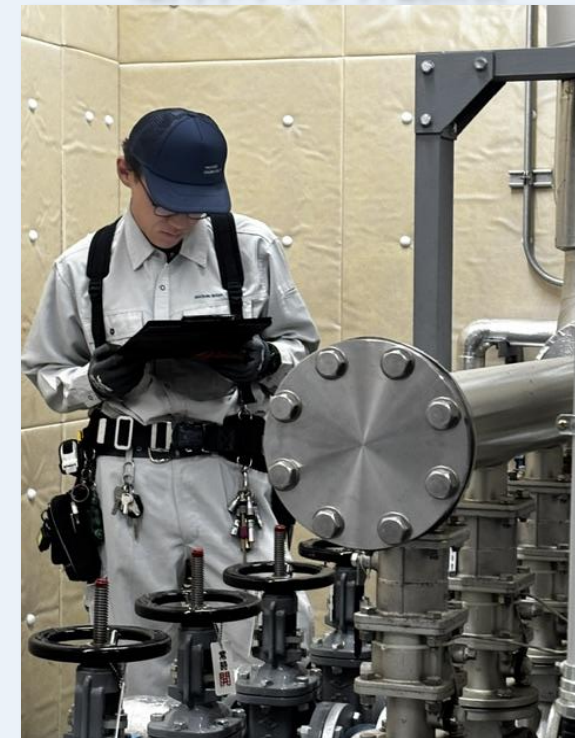
ポンプ室 雑用水ポンプ外観点検
