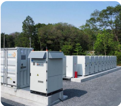
栃木小山蓄電所
