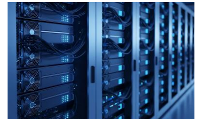
データセンター
