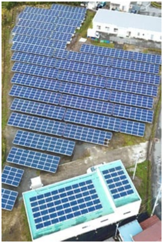
太陽光発電所
