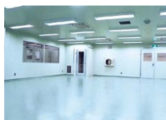
クリーンルーム
