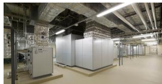
給排水衛生設備
