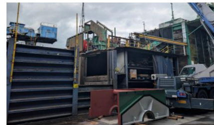
前処理破砕機（更新中）
