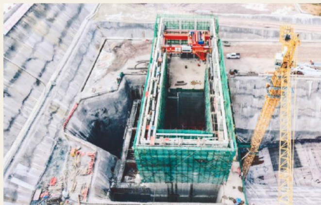
タービン発電設備
